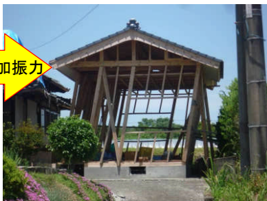
写真-1 地震水平力による構造躯体の変形
