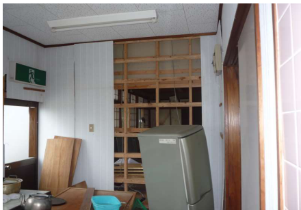
写真-4 大壁(化粧ボード)の脱落
