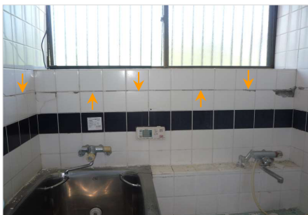
写真-7 腰回りの亀裂(下部損傷無し)
