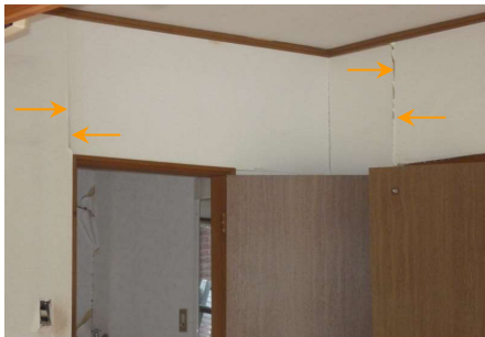
写真-1 大壁(PB+クロス)の損傷
