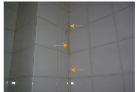
写真-6 入り隅部の亀裂と目地破損
