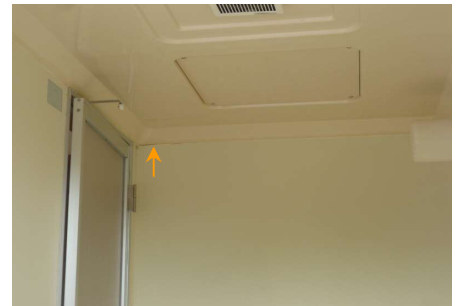
写真-3 ユニットバスパネル隙間
