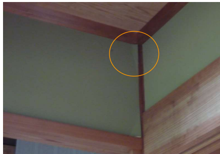
写真-2 真壁の損傷(下地ボードの浮き)
