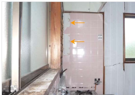
写真-5 入り隅部タイルの剥落
