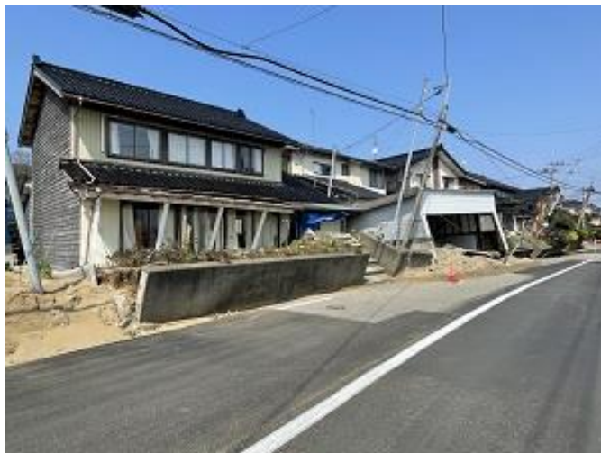
画像-2 側方流動により押し出された敷地
